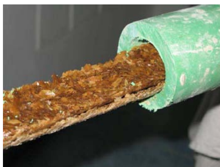
Tubazione in PVC – formazione di calcare e biofilm
