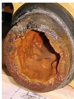
Tubazione ostruita da biofilm
